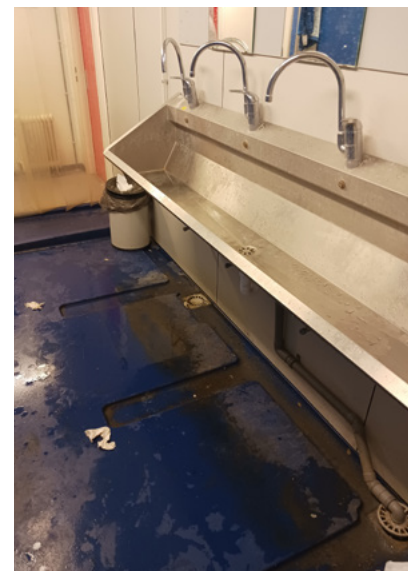
Afbeelding 10. Wastafels in no Assen (14 juni 2023)
